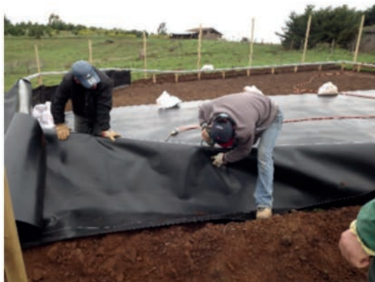
Figura 15. Instalación de la geomembrana en la estructura de soporte del área de captación.
