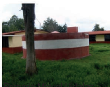
Primaria Miguel Hidalgo. Cisterna de 100.000 litros. San Andrés Tzirondaro.
