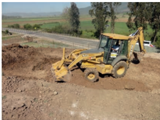
Figura 19. Trabajos de maquinaria en el movimiento de tierra y excavación del área de acumulación.
