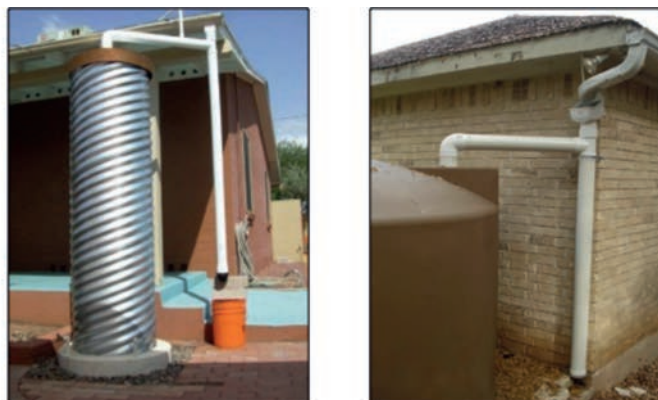
Figura 50. Los elementos no deseados que son transportados en el primer lavado se almacenan en un contenedor preliminar, el cual es un tubo vertical. Una vez lleno, la escorrentía sobrante se dirige al tanque de almacenamiento principal, gracias a la obstrucción de una bola flotante (derecha). Fuente: www.rainharvest.com y www.acmesand.com .
