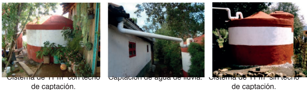
Figura 72. Ejemplos de cisternas instaladas a nivel vivienda.
