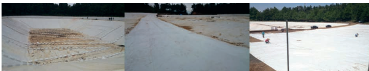
Figura 76. Instalación del SCALL en Cherán, Michoacán.
